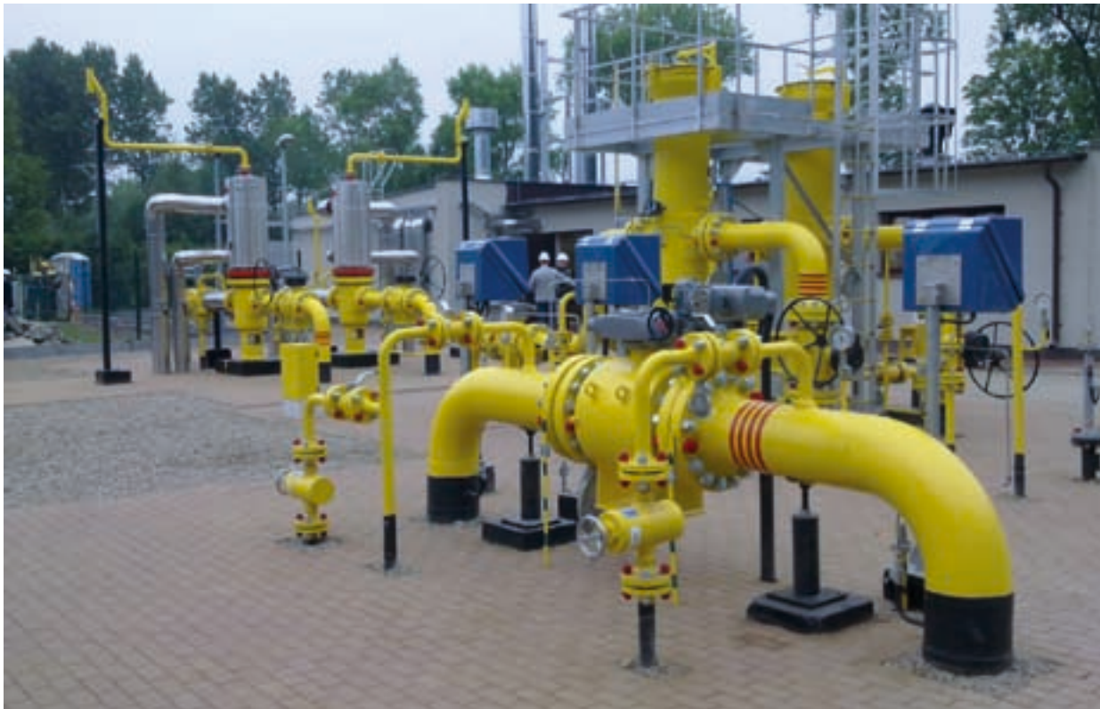
Газопровод Влоцлавек-Гдыня, узел Вичлино (фото АО "Gaz-System")
