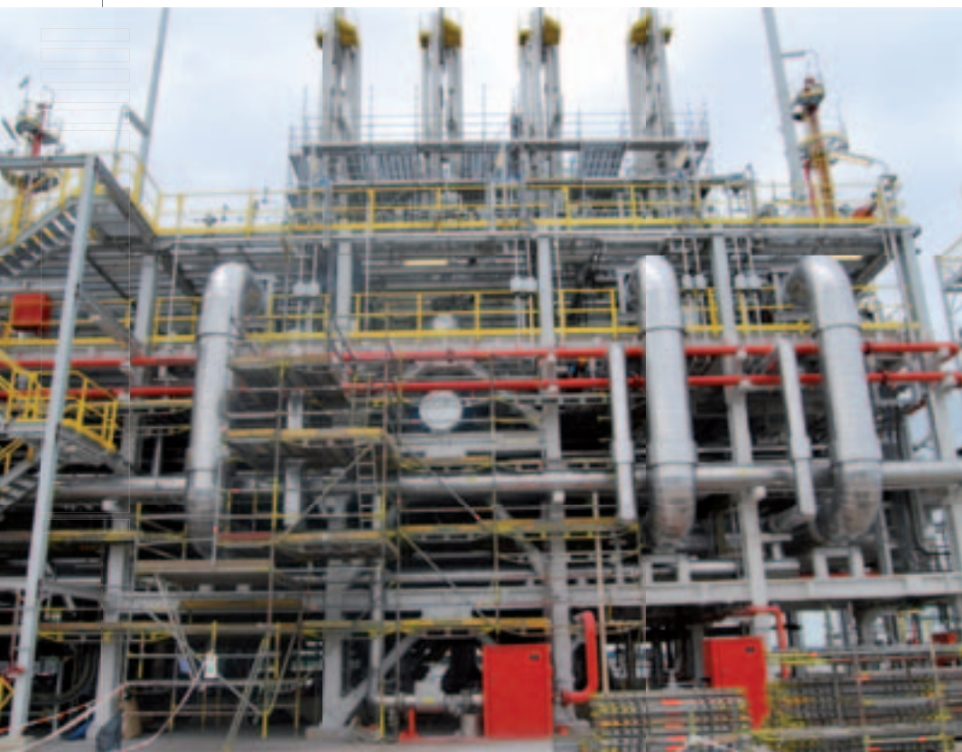
Instalacje na terminalu regazyfikacyjnym LNG w Świnoujściu
